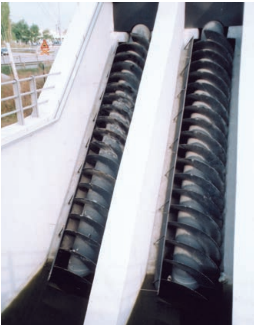
Εικ.101: Ελικοειδής αντλία στο αντλιοστάσιο εισόδου της Ε.Ε.Λ.Θ. στη Σίνδο (έλικας Αρχιμήδη).
