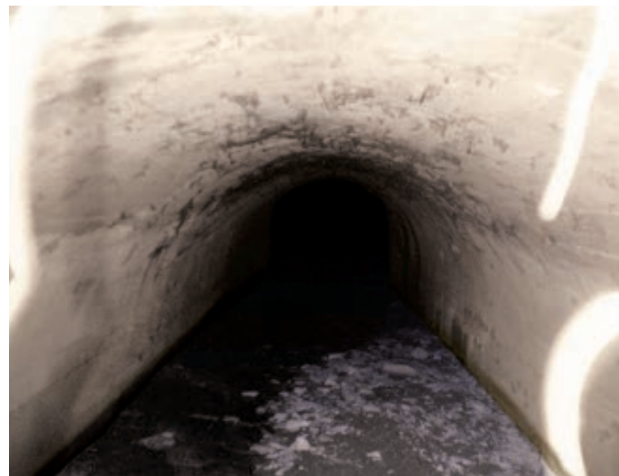
Εικ. 20: Τούρκικος αποχετευτικός αγωγός που λειτουργεί ακόμη στην Άνω Πόλη, κάτω από την εκκλησία του Αγίου Παύλου.
