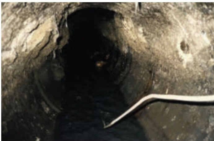
Εικ. 80: Εσωτερικό κεντρικού αγωγού αποχέτευσης εν λειτουργία (φωτογραφία: Χρ. Τραγανός).
