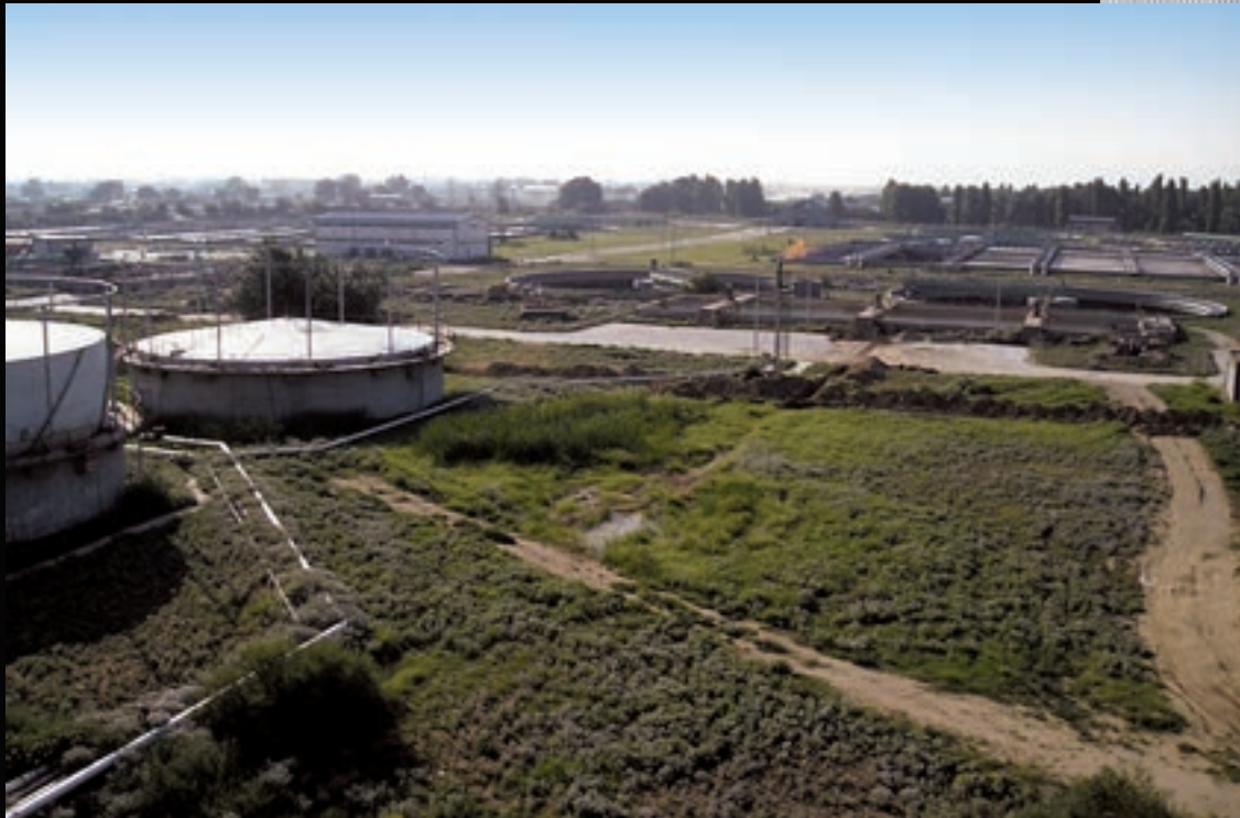
Εικ. 112: Αεριοφυλάκια, θάλαμοι φύλαξης του βιοαερίου και δοκιμαστικός δαυλός καύσης του βιοαερίου (φωτογραφία: Κ. Κωτούλας).
