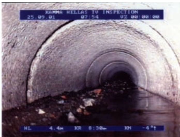
Εικ. 81: Αγωγός αποχέτευσης εν λειτουργία σε φωτογραφία από την ειδική κάμερα (φωτογραφία: Χρ. Τραγανός).
