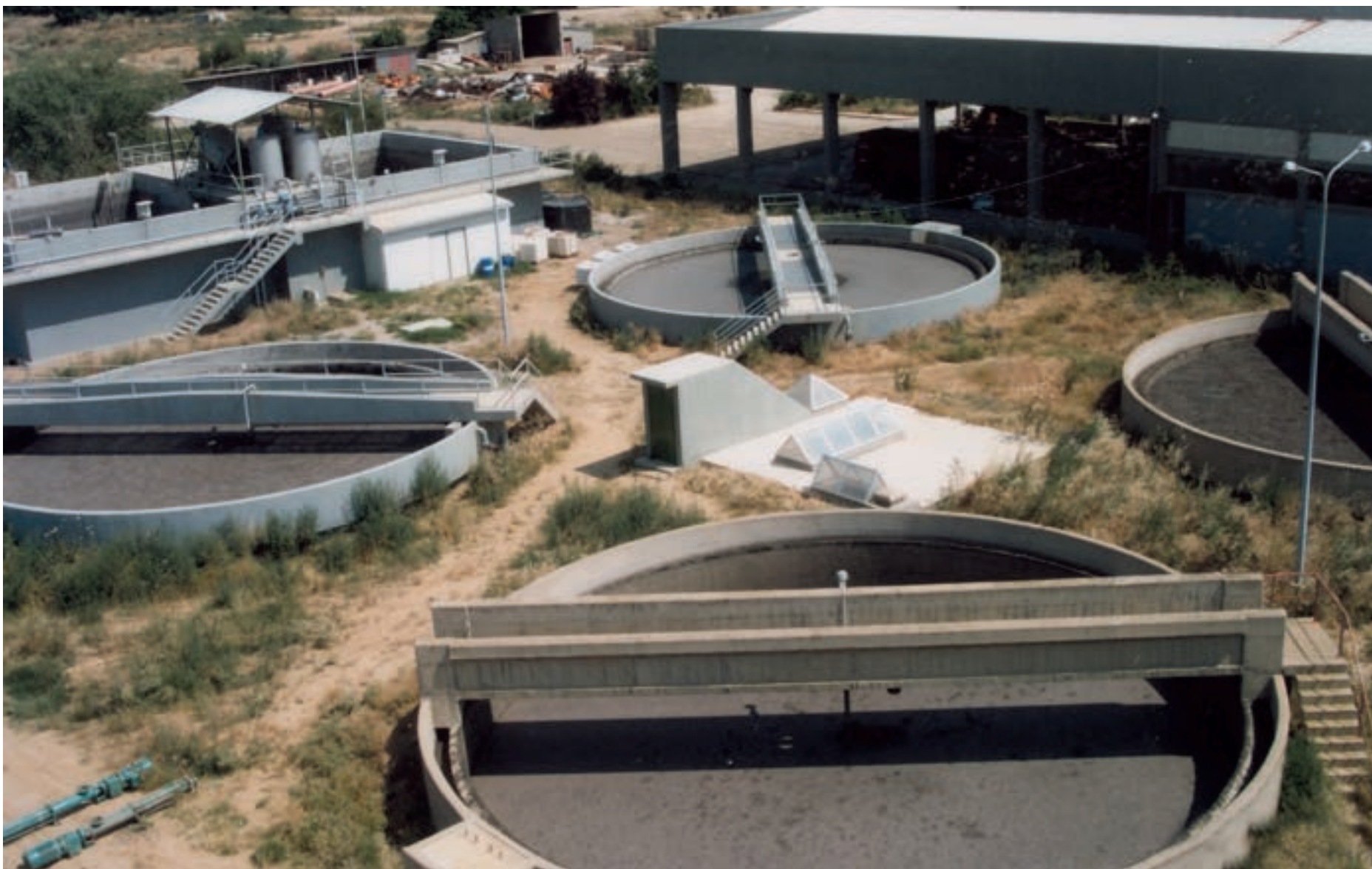
Εικ. 119: Δεξαμενές μεταπάχυνσης λάσπης (φωτογραφία: Κ. Κωτούλας).
