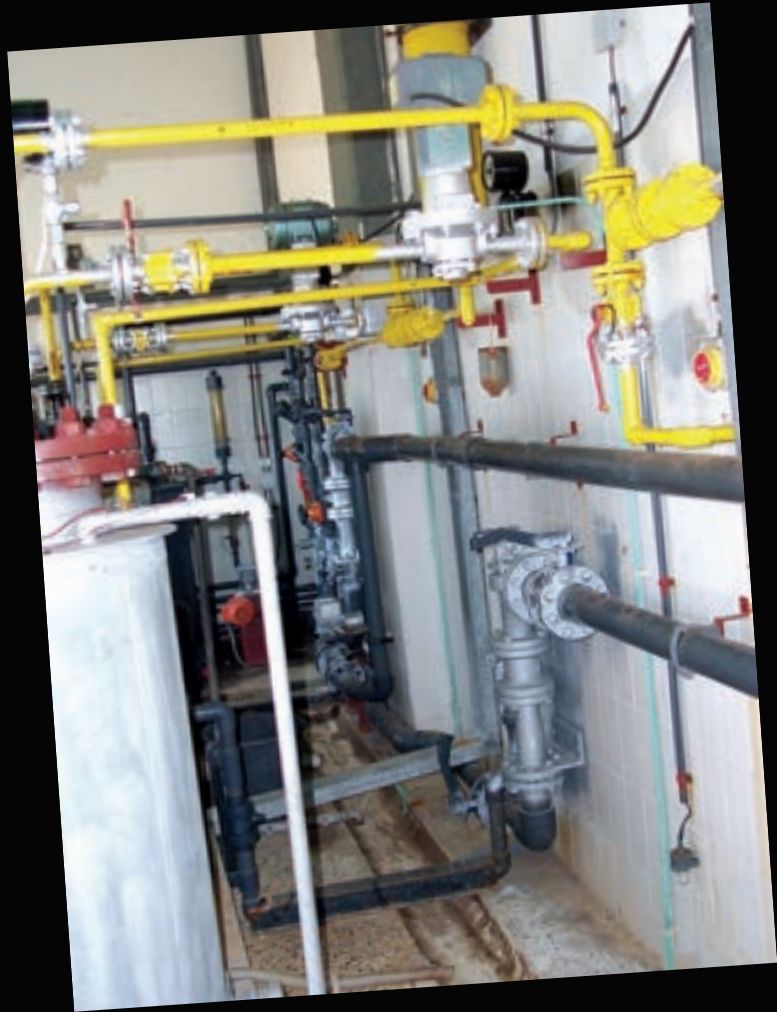
Εικ. 108: Η εγκατάσταση χλωρίωσης των επεξεργασμένων λυμάτων (φωτογραφία: Κ. Κωτούλας).
