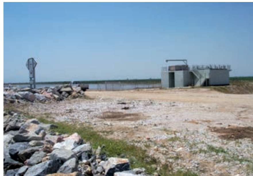
Εικ 115: Η έξοδος των επεξεργασμένων λυμάτων στη θάλασσα. Το φρεάτιο προστασίας του αγωγού από πλημμύρες της θάλασσας (φωτογραφία: Κ. Κωτούλας).
