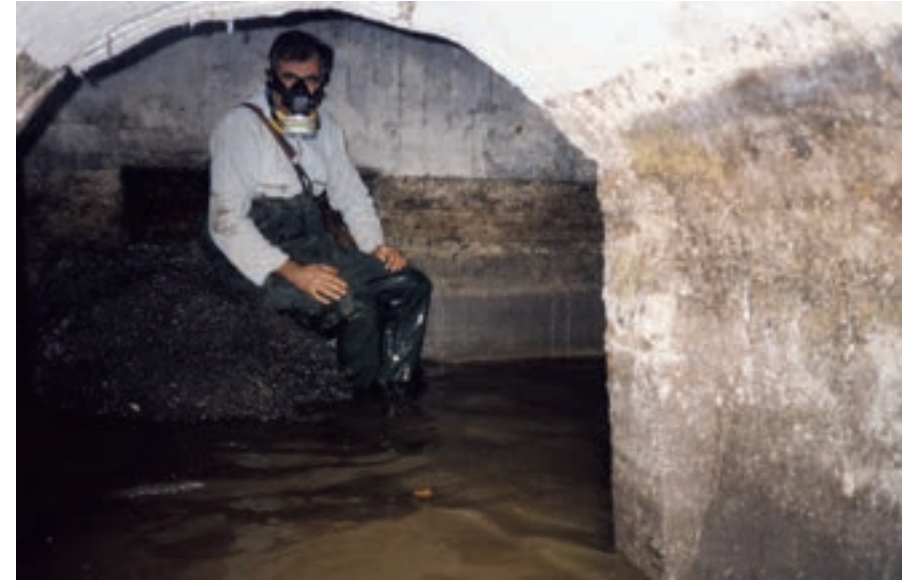
Εικ. 70: Το εσωτερικό κεντρικού αγωγού εν λειτουργία. Ο τεχνικός υπάλληλος του Ο.Α.Θ. κάθεται πάνω στο λεγόμενο «πάπλωμα» (φωτογραφία: Χρ. Τραγανός).
