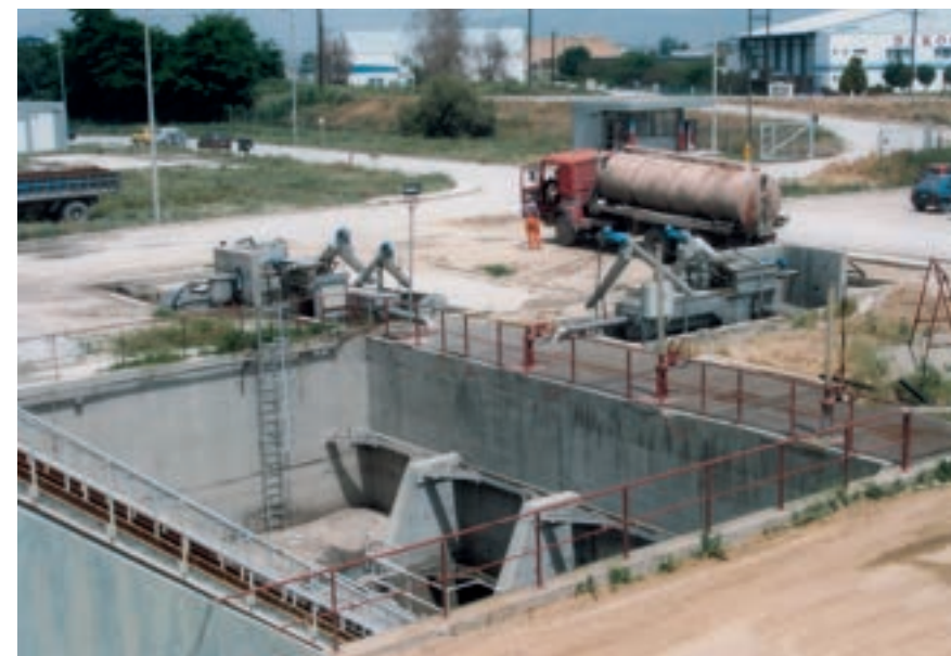
Εικ. 99: Υποδοχή βοθρολυμάτων από αυτοκίνητο μεταφοράς.
