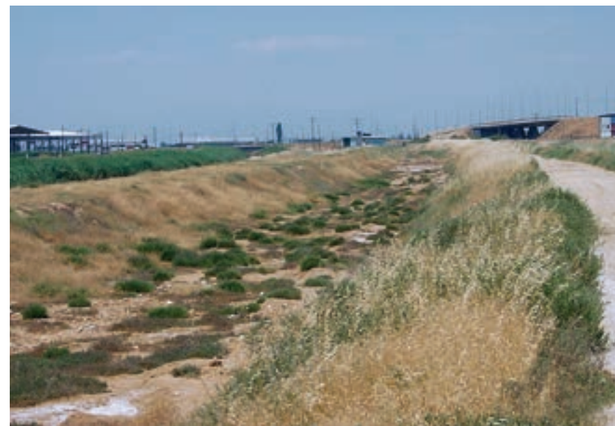
Εικ. 118: Στο πρανές αυτού του σκάμματος είναι τοποθετημένος ο διπλός σωληνωτός αγωγός μεταφοράς των επεξεργασμένων λυμάτων μέχρι τη θάλασσα.
