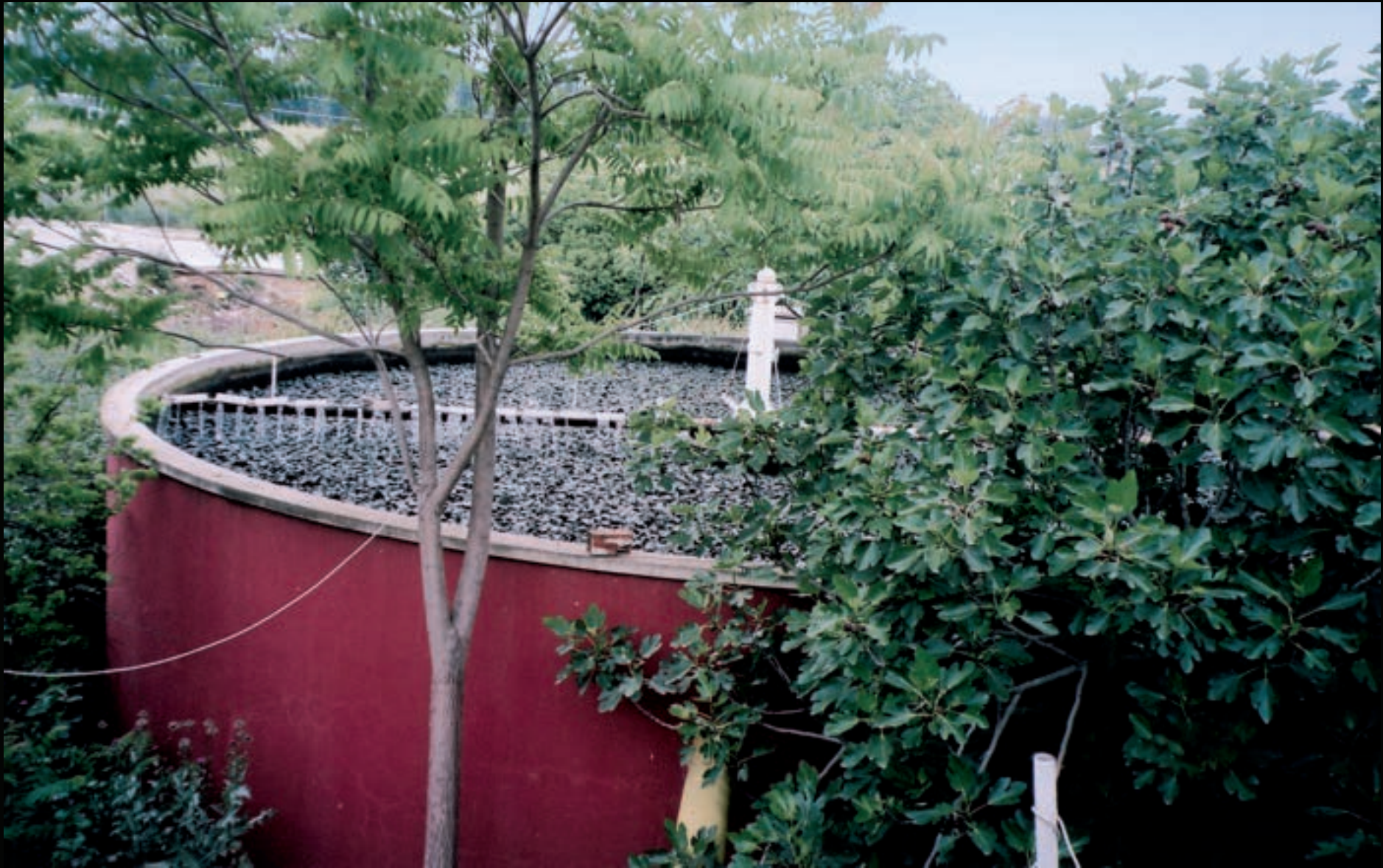
Εικ. 67: Η πρώτη δεξαμενή του Βιολογικού Καθαρισμού Φοίνικα, όπου ψεκάζονται τα λύματα στις πέτρες της δεξαμενής.
