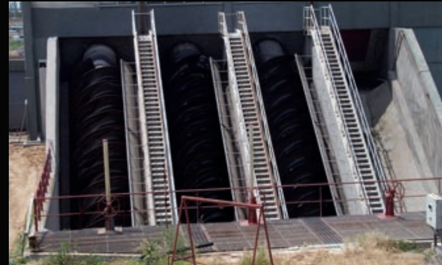
Εικ. 103: Το αντλιοστάσιο ανύψωσης στην Ε.Ε.Λ.Θ.
