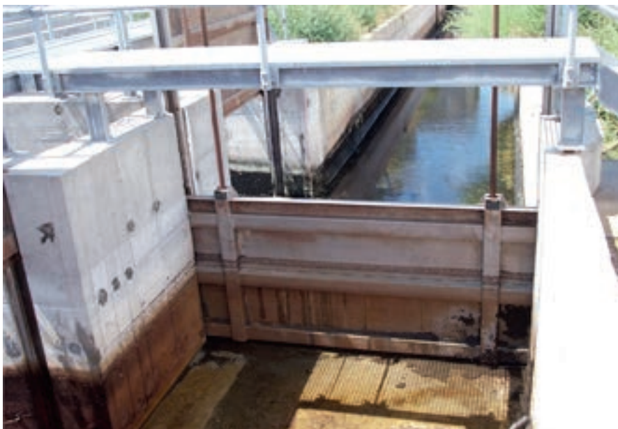
Εικ. 114: Η αρχή της μαιανδρικής κατασκευής που χρησιμοποιείται για την απολύμανση των επεξεργασμένων υγρών αποβλήτων (φωτογραφία: Κ. Κωτούλας).
